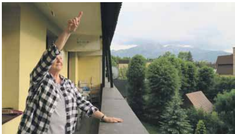
Woda z dachu spada na szeroki parapet i zalewa cały balkon, w dodatku pod parapetem mam teraz wielki gołębnik - przekonuje Barbara Wojna.
