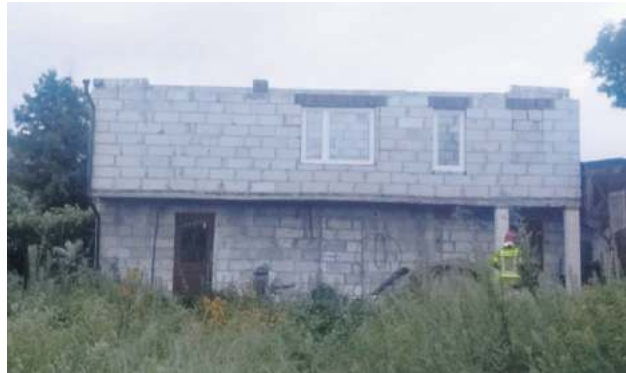
Z budynku przy ul. Usługowej dach został zerwany i w całości wyładował na sąsiedniej posesji.
