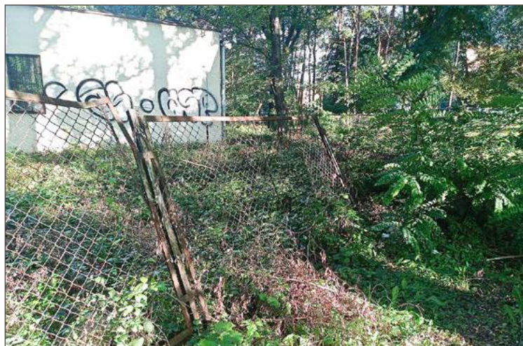
Po sierpniowej wichurze ogrodzenie wygląda jeszcze gorzej niż wcześniej.
