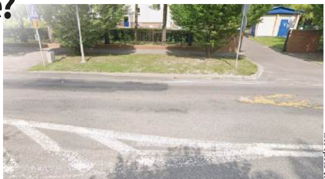
Od przynajmniej dwóch lat radni miejscy zwracają uwagę na stan ul. Lubelskiej, a zwłaszcza na ten jej odcinek, gdzie zlokalizowane są przejścia dla pieszych. Ostatnią interpelację w sprawie przejścia dla pieszych w pobliżu szkoły podstawowej skierował do urzędu radny Mariusz Grams.
