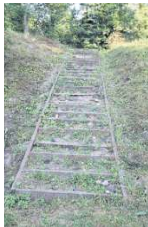
Zaniedbane schodki prowadzące na grodzisko w Horodlu.
