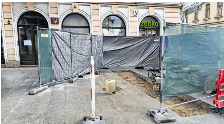
• Skrzyżowanie Piotrkowska – Nawrot. Montaż systemu kontroli wjazdu
