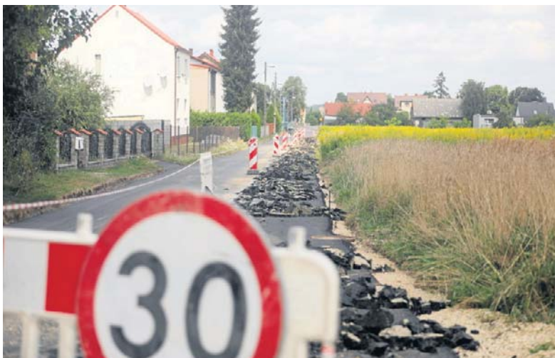
Droga przeorana przez ciągnik ma zostać naprawiona
