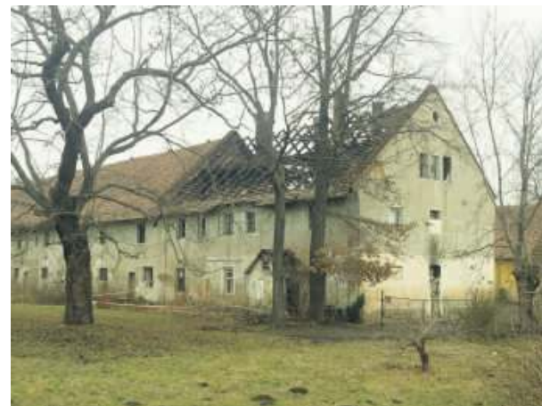
Stan techniczny budynku oceni nadzór budowlany, a właściciel zdecyduje, czy poniesie koszty odbudowy
