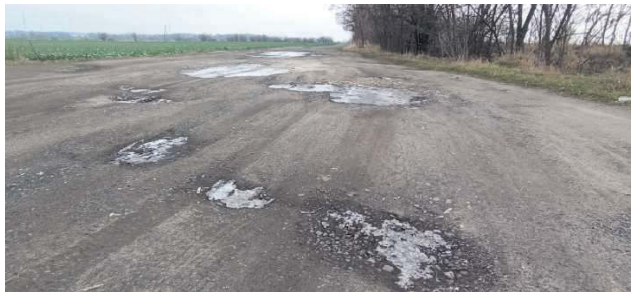
Droga dojazdowa do zbiornika „czeczenia” w gminie Wiązów ma szansę na remont
