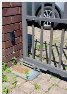
❷ Pokrywę podziemnej skrzynki zdejmujemy, przy oczyszczaniu jej wnętrza i drenów. Na słupkach ulokowano fotokomórki.
