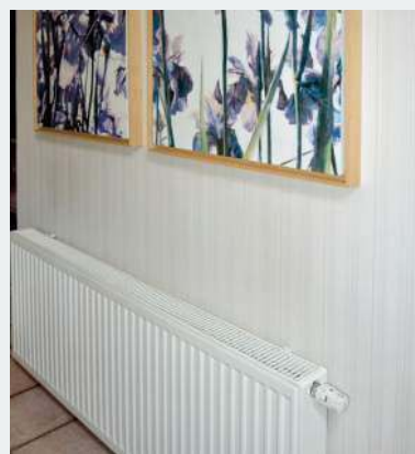
Do instalacji z miedzi podłączono grzejniki płytowe ze stali, każdy wyposażony w zawór termostatyczny z głowicą sterującą.
