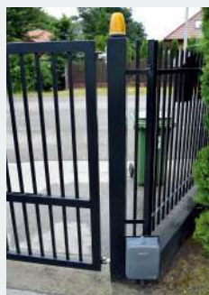
Centralę sterującą umieszczono ponad poziomem podjazdu, na słupku lampę ostrzegawczą.
