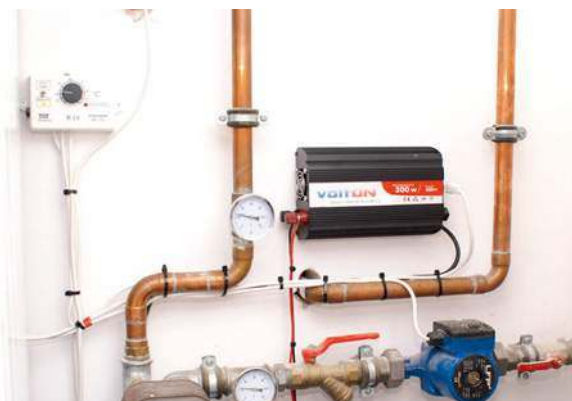
❏ W naszym kraju układy off-grid najczęściej mają bardzo małą moc i służą do zasilania awaryjnego urządzeń o krytycznym znaczeniu, np. pomp obiegowych c.o. VOLTON
