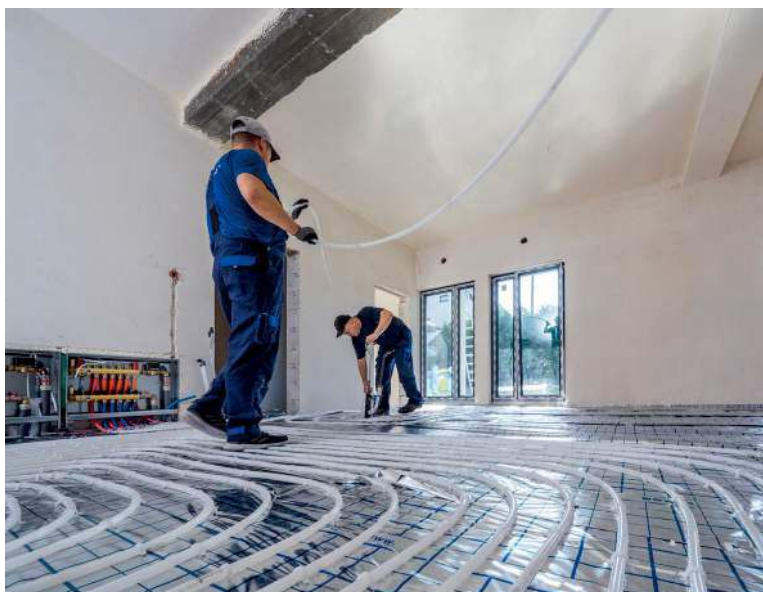
W podłogówce wodnej, pętle wykonane są z rur (zatopionych w warstwie betonu), przez które przepływa woda, ogrzana przez kocioł lub pompę ciepła. PIPELIFE
