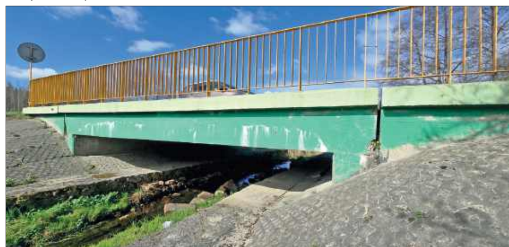
Konieczna będzie budowa nowego.
