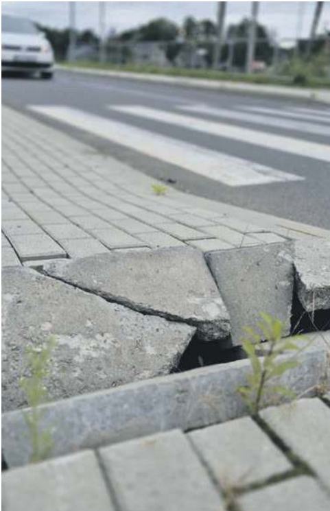
(e) Popekane płyty przy drodze serwisowej w Woli Filipowskiej
