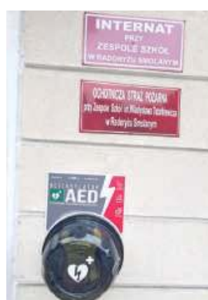
Defibrylator AED na budynku szkoły
