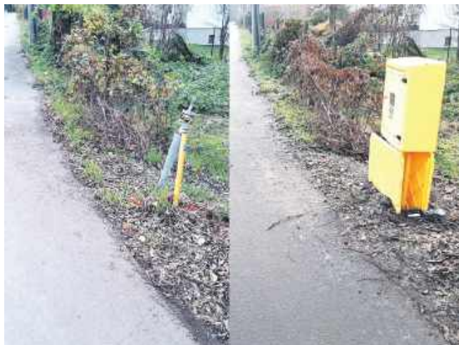
Rury po naszej interwencji zostały obudowane
