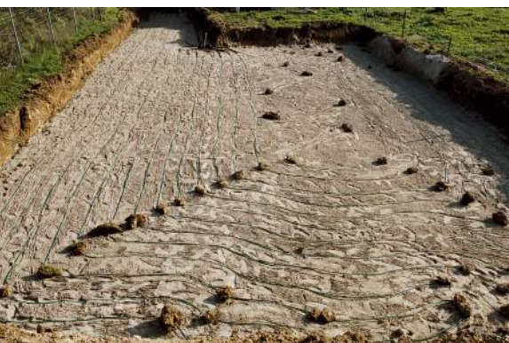
🔥 Pompy gruntowe nie są tak popularne, jak powietrzne, ponieważ budowa źródła dolnego jest droga i nie zawsze możliwa. ARCHIWUM BD
