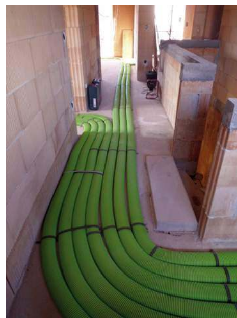
🔹 Rekuperację można wykonać zarówno w budowanym, jak i użytkowanym już domu, choć w drugim przypadku znacznie trudniej jest zamaskować kanały wentylacyjne. wolf
