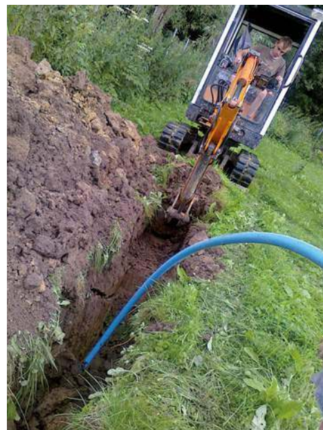
🔧 Wykonanie instalacji gruntowej jest dość kłopotliwe i sporo kosztuje. Jednak zyskujemy źródło dolne o stabilnej temperaturze. DANFOSS
