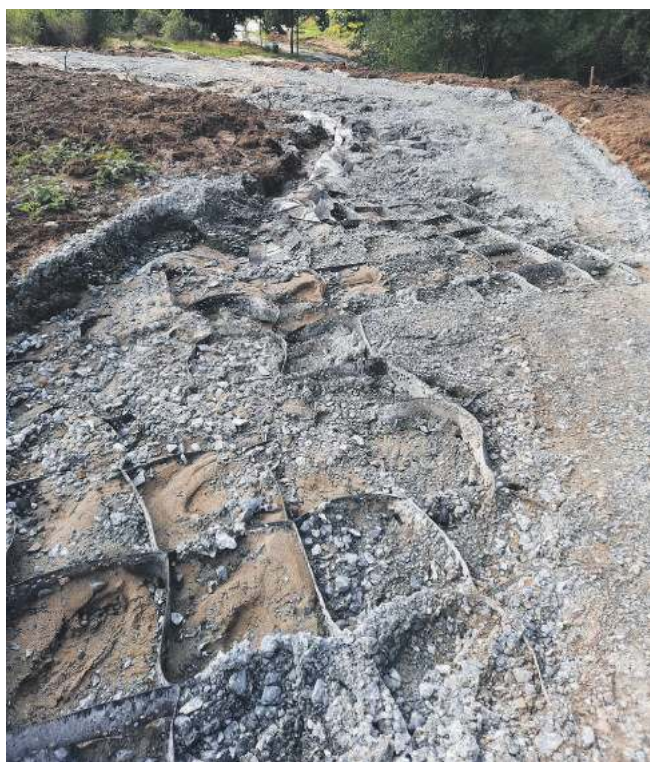
Woda obnażyła i pokazała, jak wykonana jest podbudowa
