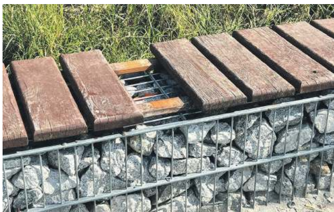
Niszczone są też siedziska
