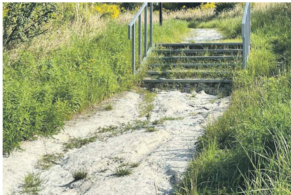
Przyroda pokazała, jak źle wykonano I etap inwestycji. Czy burmistrz wystąpił do wykonawcy o naprawę w ramach gwarancji?
