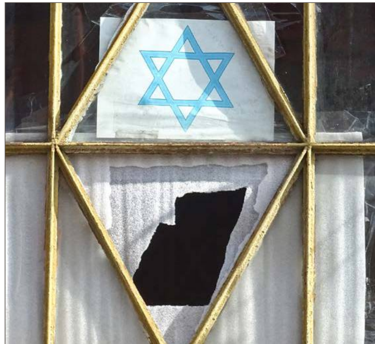
Dawna synagoga nowomiejska wymaga pilnego remontu.
