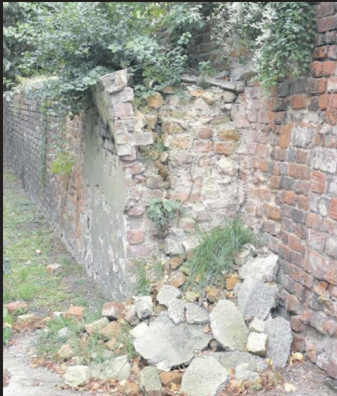
Niszczyjący fragment dawnych murów - stan obecny
