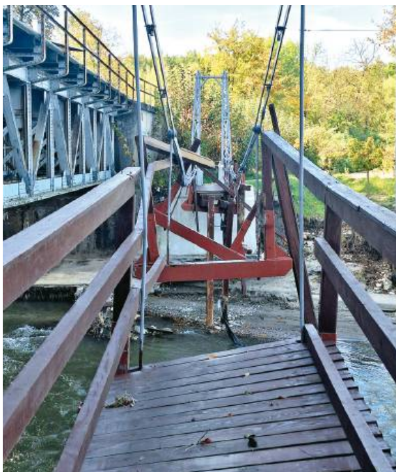
Pozostałości zabytkowego mostku w Głuchołazach.
