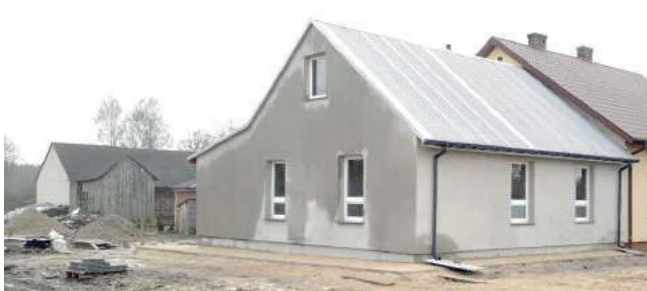
Tak aktualnie wygląda dom Kacpra. Rodzina potrzebuje pieniędzy na zapłatę budowlanców i budowę ogrodzenia. Chce także utwardzić tłucznem podwórkę, bo po opadach deszczu teren przylegający do domu wygląda właśnie tak, jak na zdjęciu - jest grząsko i nie da się przejść suchą nogą
