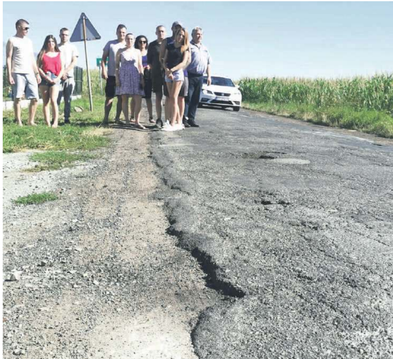
Mieszkańcy Miłonowa mają dość. Grożą protestem, jeśli nie będzie pieniędzy na remont tej strasznej drogi...
