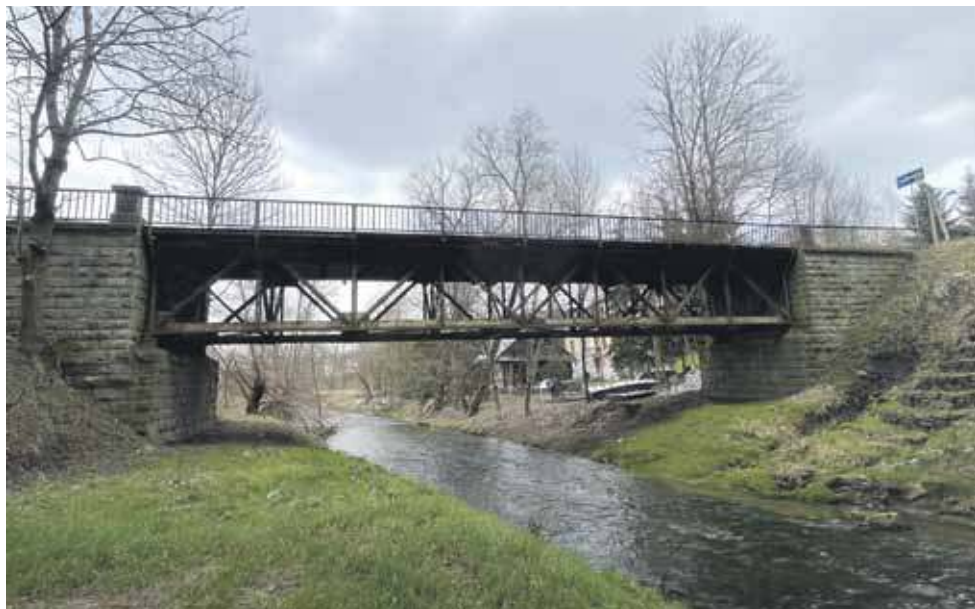
Most na Rabie grozi zawaleniem.
