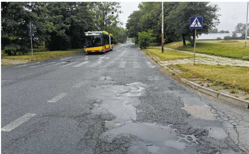
• Ulica Śnieżna wymaga pilnego remontu
