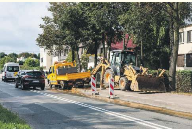
Awarie wodociągu na ul. milickiej każdorazowo kończą się rozkopaniem chodnika
