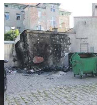
Spaleniu uległo ocieplenie części budynku
