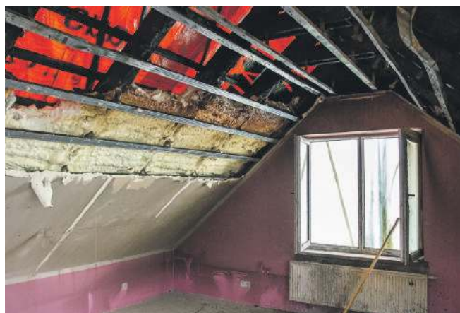
Konstrukcja dachu wymaga wymiany
