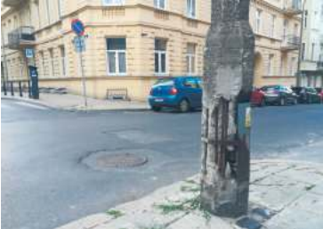
Na wymianę czekają jeszcze m.in. latarnie przy ul. Niecałej
