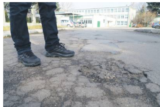
W złym stanie technicznym jest droga prowadząca do szkoły
