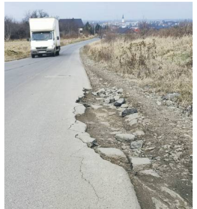
Takich uszkodzeń na części ul. Sosnowej jest więcej
