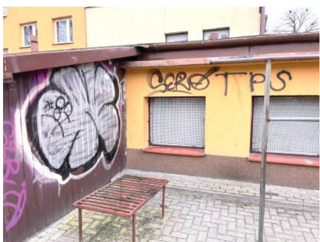
W Tomaszowie Lubelskim uszkodzono sześć budynków należących do Spółdzielni Mieszkaniowej
