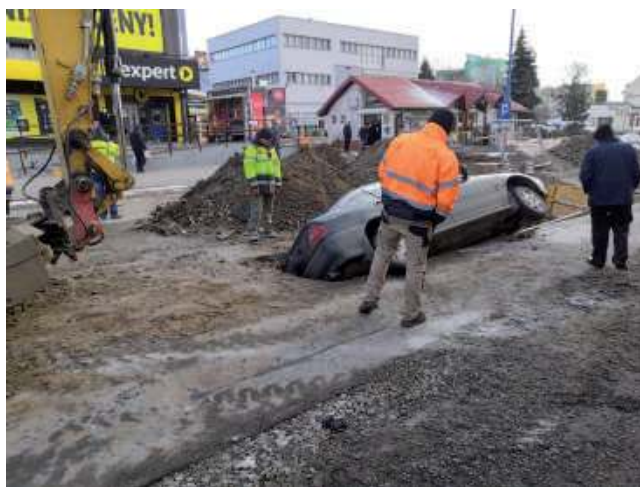
Kierowca jechał hondą pod prąd i wpadł do głębokiego wykopu tuż przed rondem
