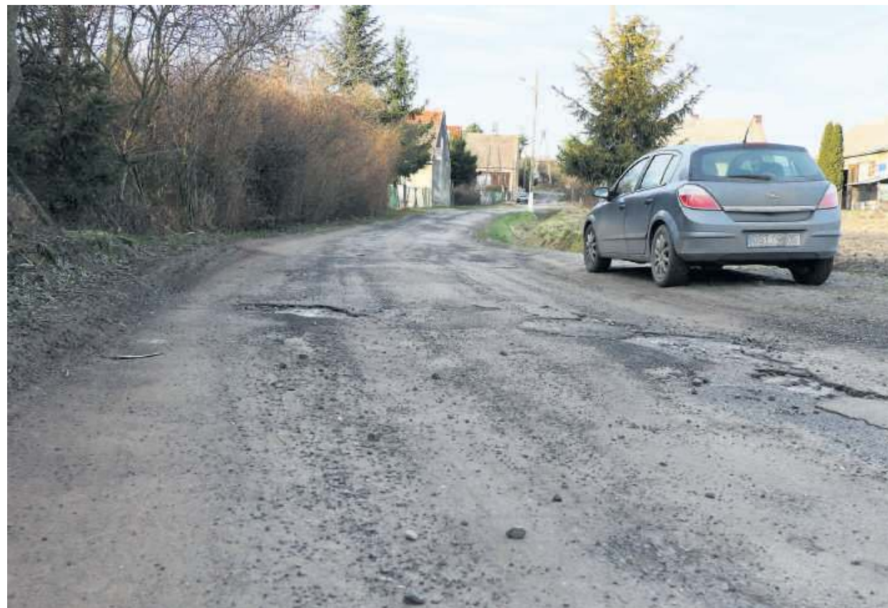
Dziury w nawierzchni drogi powiatowej Krzywina – Samborowiczki
