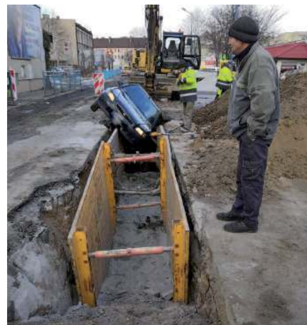
Wykop, w miejscu do którego wpadł samochód miał ponad 2,5 m głębokości, a wcześniej byli tam pracownicy drogowi
