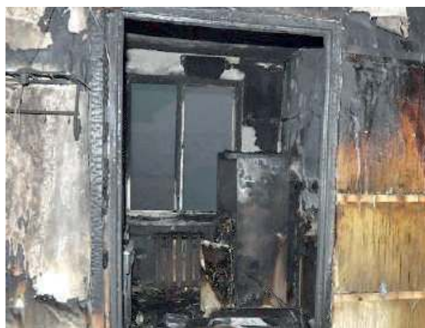
Spaleniemu uległo m.in. wyposażenie kuchni, korytarza
