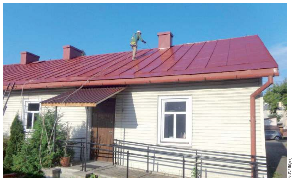
Doraźne tatanie dziur i naprawianie dachu w budynku biłgorajskiego PCK, już nie wystarcza
