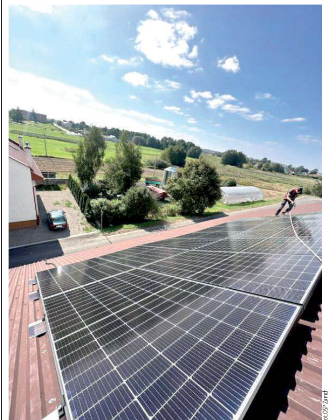
Strażacy z OSP Zamch mają teraz własną instalację fotowoltaiczną
