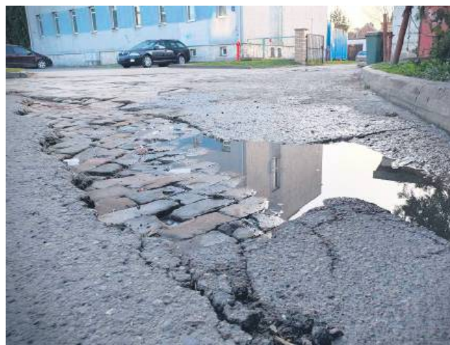
Stan nawierzchni jest katastrofalny.
