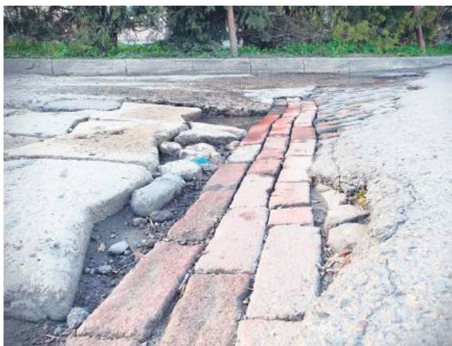
Odcinek drogi jest podziurawiony i sklecony z kilku rodzajów nawierzchni.
