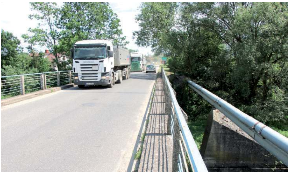
W piątek, 26 czerwca, byliśmy na moście, kiedy przejechały dwa samochody ciężarowe. Nawet jeśli miały puste naczepy, to na obiekcie znalazły się w tym samym momencie. Drgania podłoża i barierki dały się wyraźnie odczuć
