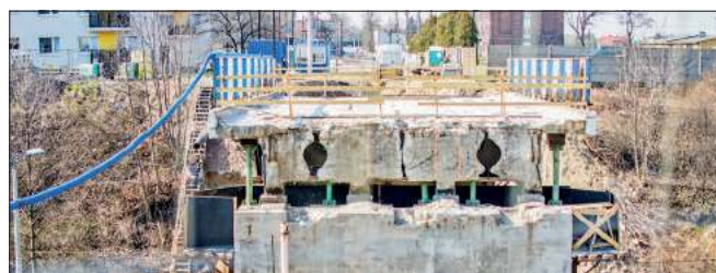
Przebudowa wiaduktu wzdłuż ul. Mariackiej w Radlinie utknęła w martwym punkcie. Powód? Sytuacja epidemiologiczna na terenie Polski.
