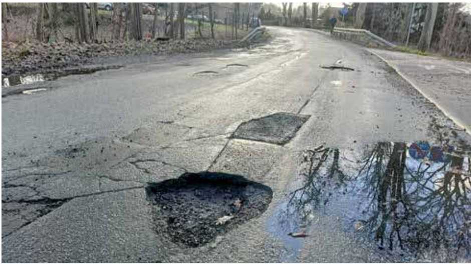
Dziury na Spacerowej są bardzo głębokie
