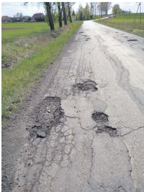
Droga między Prusami a Żelowicami jest tak dziurawa, że aż niebezpieczna
