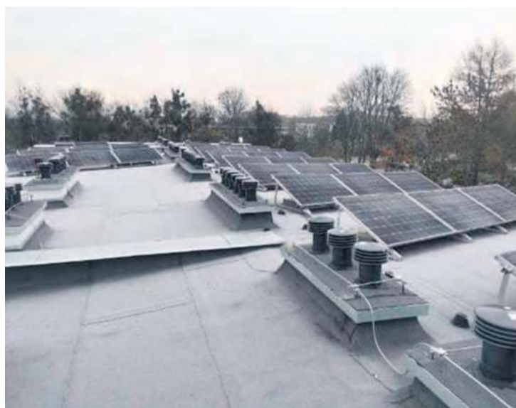
Prace związane z termomodernizacją dachu tucholskiego przedszkola zakończyły się w połowie listopada.
