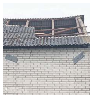
Strażacy przyjęli zawiadomienia o pięciu uszkodzonych dachach.
