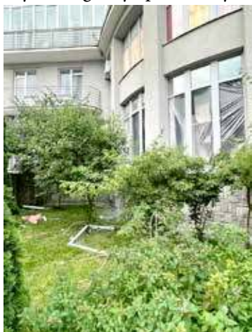
Podczas uderzenia z budynku wypadły okna
