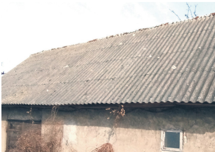
Na wielu budynkach leży jeszcze eternit.
