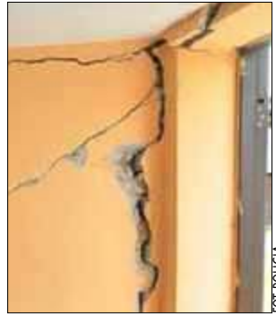
Siła eksplozji spowodowała uszkodzenie jednego pomieszczenia w budynku, w którym znajdowała się letnia kuchnia
