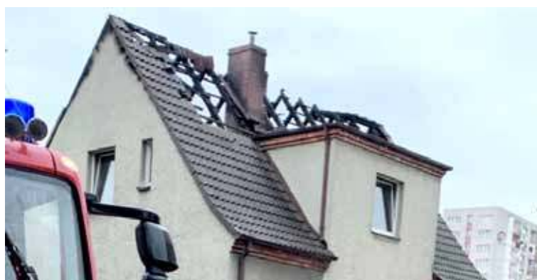
Na skutek pożaru spłonął dach oraz poddasze budynku. Foto. Stoją!Stargard
