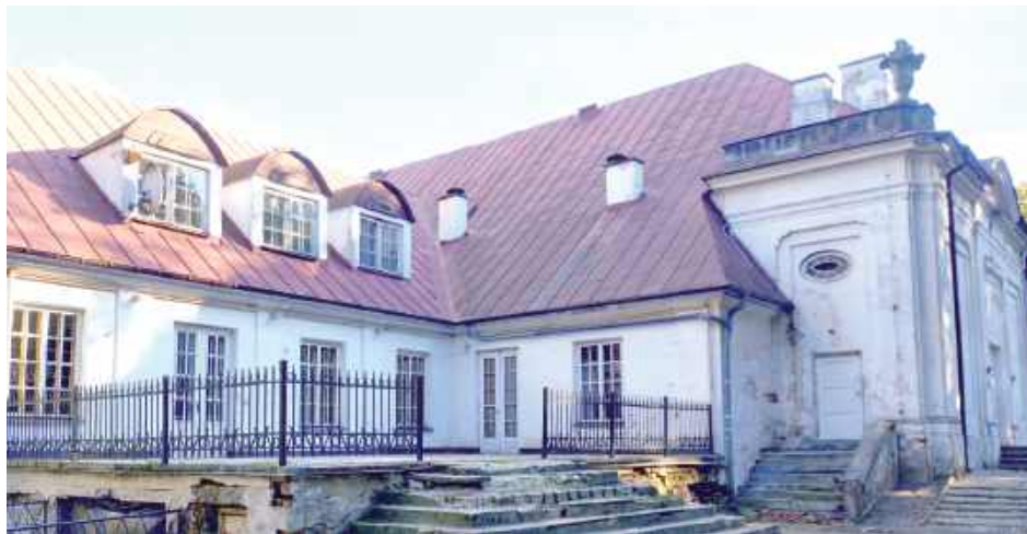
Na remont Oranżerii wciąż nie ma pieniędzy, ale firma za napisanie wadliwego wniosku na rewitalizację budynku, z błędami dotyczącymi np. złego wpisania dat, otrzyma wynagrodzenie w wysokości 22 400 zł
