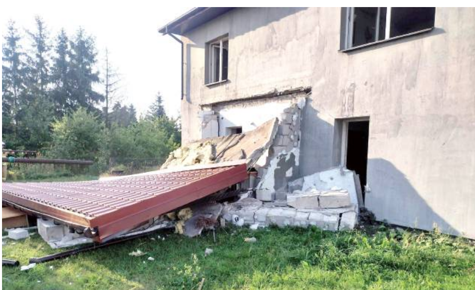
Wybuch gazu całkowicie zniósł przybudówkę domu, wybił okna i drzwi W (fot. Straż Pożarna Łuków)
