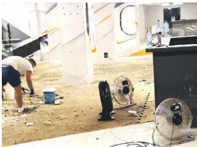
Dolne pomieszczenia basenu zostały całkiem zalane i zniszczone
