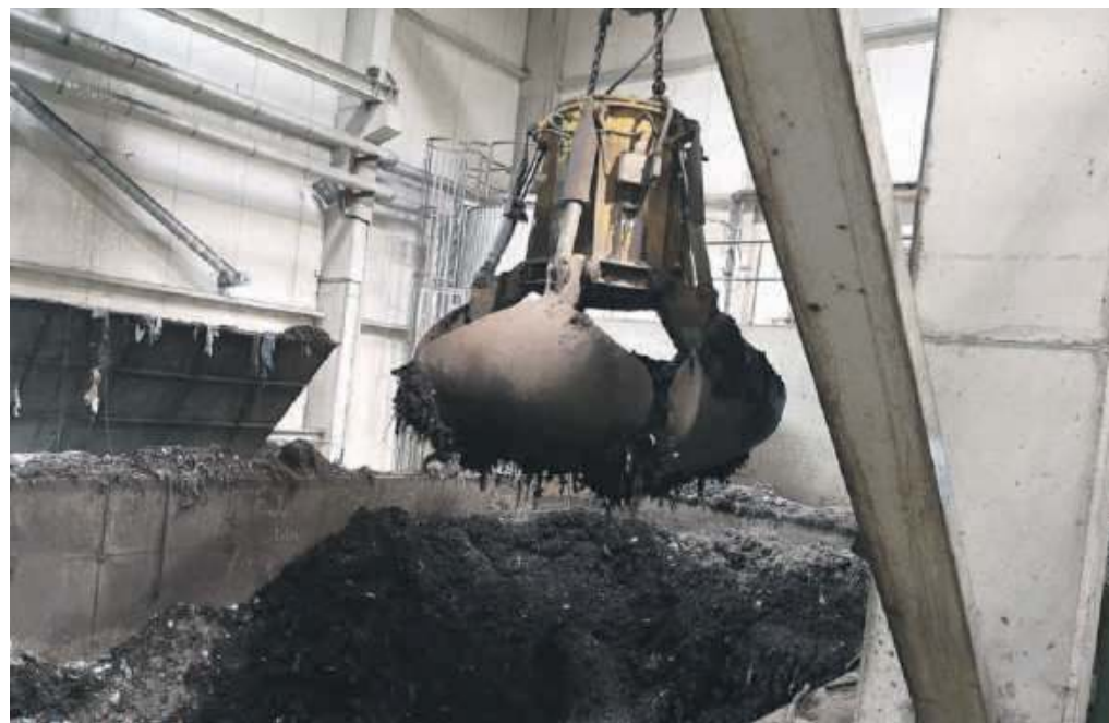
Magazyn wsadu do fermentacji z automatycznym chwytakiem
