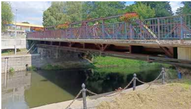
Stan mostu pozostawia sporo do życzenia
