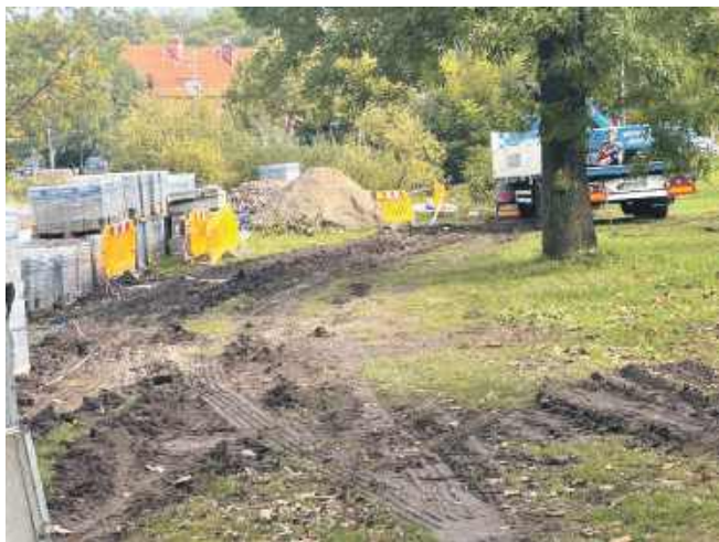
Przy okazji budowy zniszczeniu uległy też trzebnickie błonia. Ale pewnie teren zostanie naprawiony
