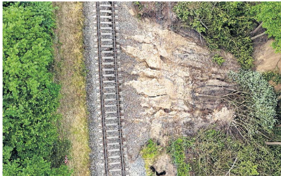
Ulewny desz podmył około 40-metrowy odcinek torów w okolicach Gorzuchow
