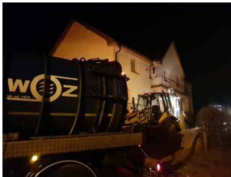
Uszkodzeniu uległa rura biegnąca przez teren parafii w Grzędzicach
