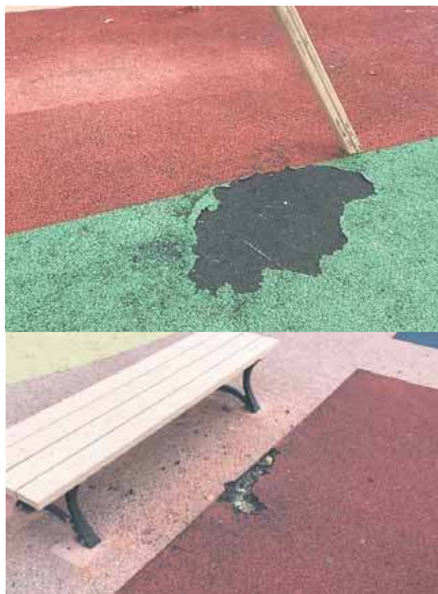
Zniszczona nawierzchnia placu zabaw
