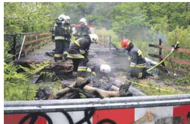
W czerwcu 2020 r. spłonęła większa część mostu nad Małą Panwią w Kaletach FOT. JAROSŁAW MYŚLIWSKI
