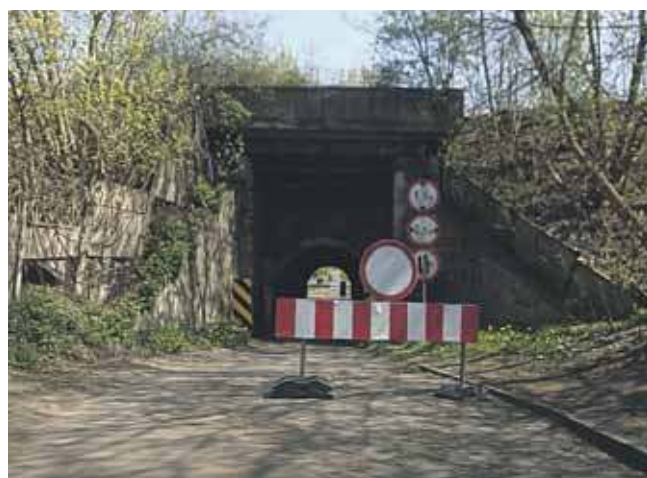
Podobno w tym miesiącu droga pod wiaduktem ma być naprawiona FOT. ARCHIWUM CZYTELNIKA
